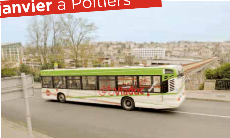
■ Les travaux pour le remplacement de la passerelle des Rocs par un ouvrage moderne et large sont engagés, entraînant sa fermeture avant démontage. Une navette gratuite relie les deux extrémités, matin et soir.
